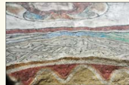
Helt oppe i kortaket ser man tydelig spor etter forskalingen som ble brukt for vel 800 år siden.
