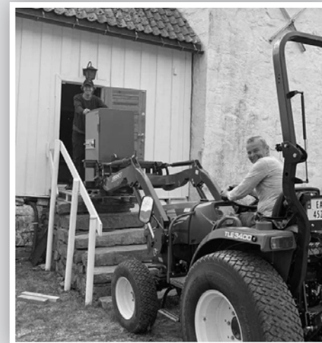
"Olsenbanden" ved Sauberad kirke? Falke Solberg og Jan Odden Kåsin flytter safen i forbindelse med renoveringen. Jan sitter på den nye parkraktoren. Foto: Silje Sognen
